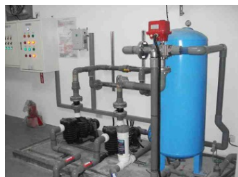
雨水回收控制設備
