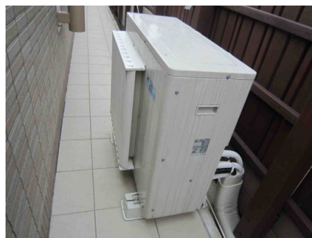
變頻空調主機
