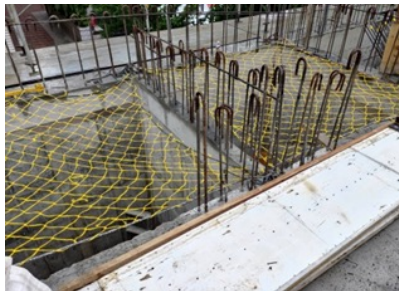
隨時做好開口防護，防止墜落危害發生
