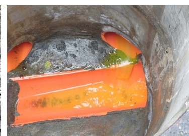
污水配管局部
