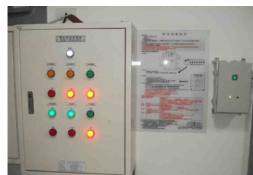
雨水回收控制設備
